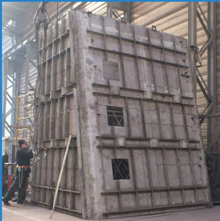
Диффузор котла- утилизатора Джубгинская ТЭС.
